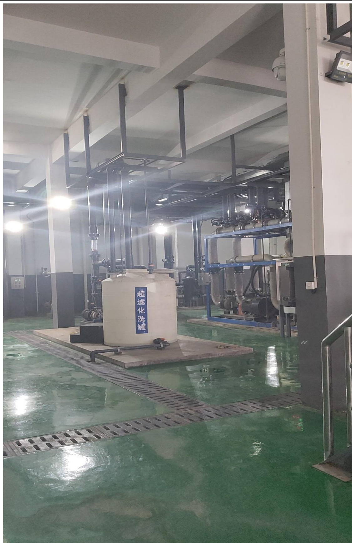
废水处理设施
