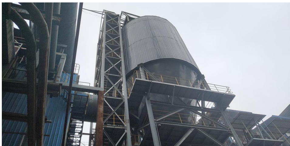
附件 7：现场设备及防护措施照片
