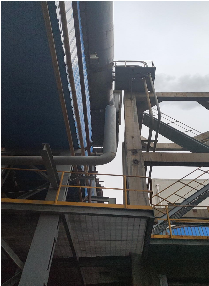
废气处理系统
