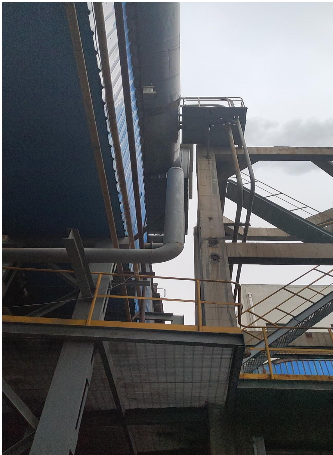
废气处理装置
